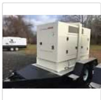
50 kw Kohler 50REOZJN Industrial...
