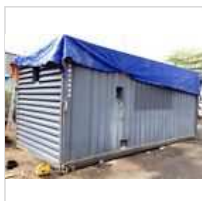
2001 Cummins generator KTA19G4
