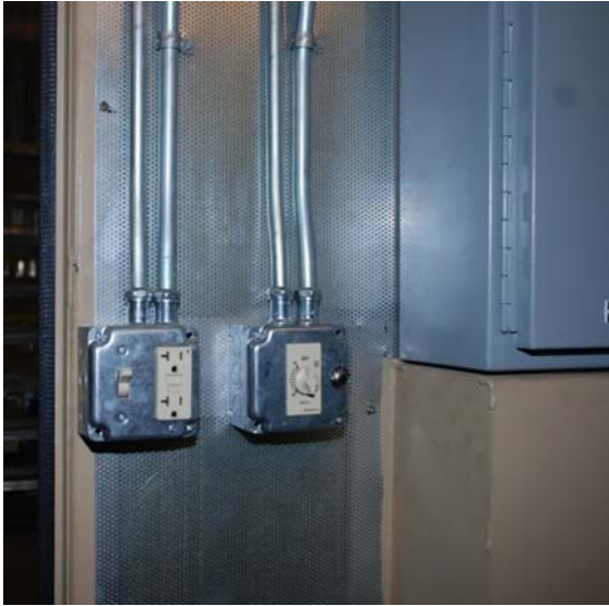
Outlets (Receptacles) 120V
